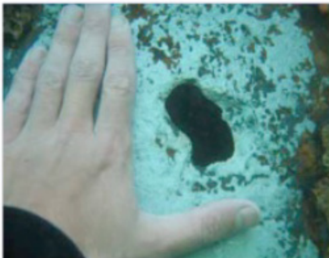
Rys. 22: Korozja wżerowa oraz perforacja ścian stalowych pali spowodowana korozją mikrobiologiczną (MIC). 28
