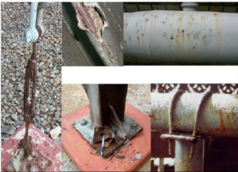
Rys 17: Korozja materiałów konstrukcyjnych spowodowana środowiskiem o wysokiej korozyjności. 26
