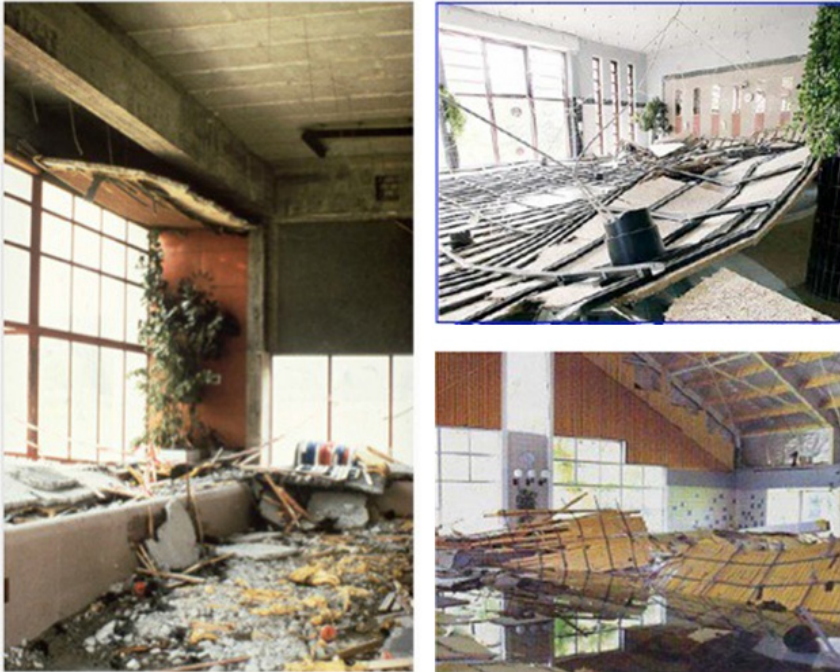
Rys. 29: Oberwanie się sufitów podwieszanych na pływalni z powodu zastosowania niewłaściwych elementów mocujących. Awaria spowodowana została spękaniami w wyniku korozji naprężeniowej. 41
