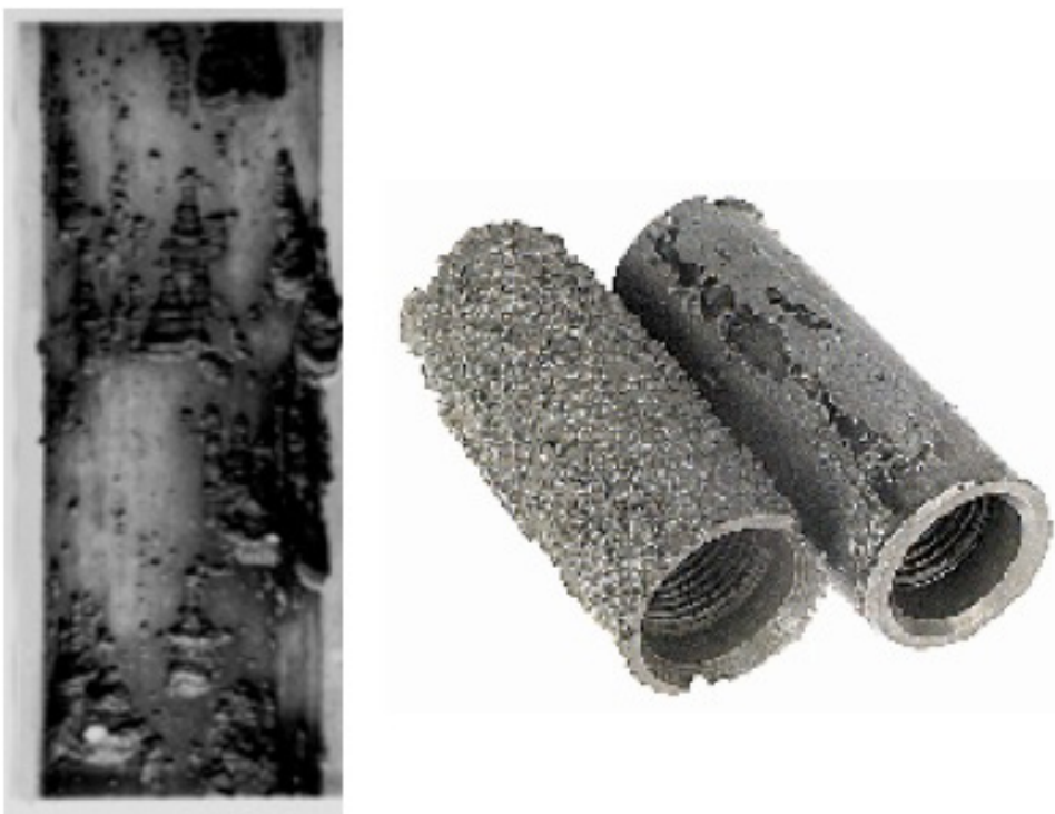
Rys. 13: Korozja rur spowodowana oddziaływaniem \text{CO}_2 .
