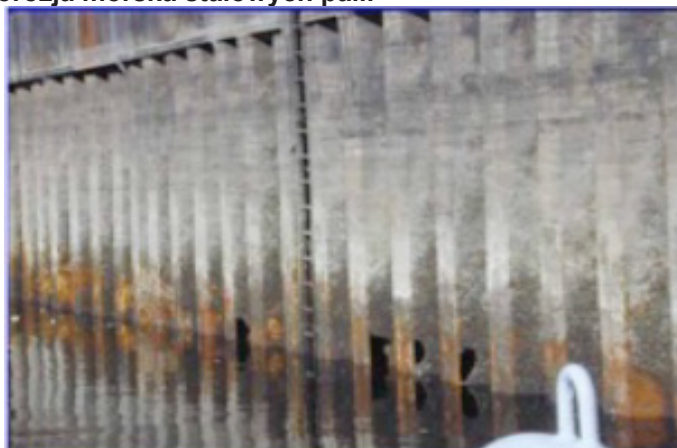
Rys. 21: Korozja grodzic w strefie niskiej wody. 29
