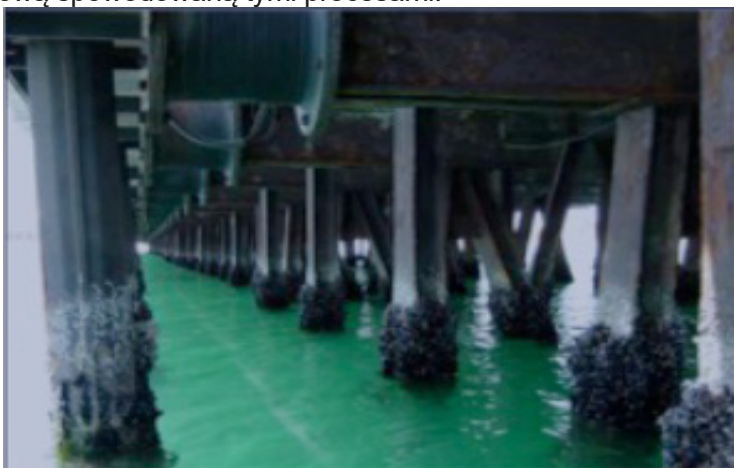
Rys. 20: Korozja morska stalowych pali. 28
