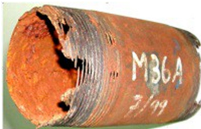
Rys. 4: Uszkodzenie materiału spowodowane korozją.
